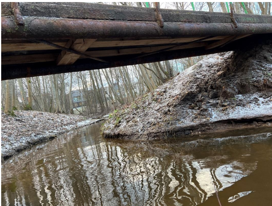
1.att. Korodē laiduma konstrukcija.
